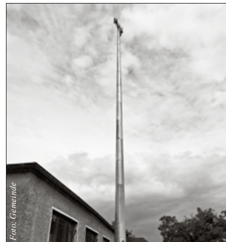
Neu errichtete freistehende Mastsirene in Diera (gefördert über Richtlinie des SMI über die Gewährung von Zuwendungen zur Anschaffung und Errichtung von Sirenen)
