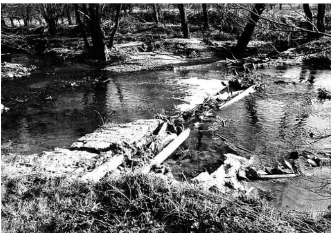
Der Rest des Wehres im Ketzlerbach nach dem Hochwasser (Foto: April 2003)
