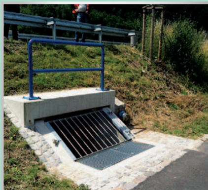
Feuerlöschentnahmestelle und Bau Teilortskanäle an der B6 Bereich Keilbusch-Zehren
