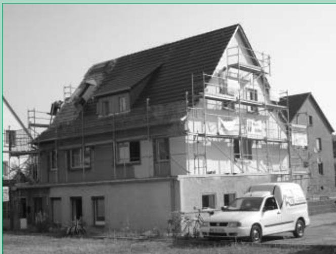
Dach- und Fassadensanierung des Gemeindeamtes Nieschütz durch die örtlichen Firmen Dachdeckermeister Simon und Malermeister Stiller
